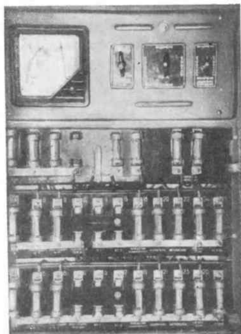
Рис. 2. Распределительное устройство 9-РЩ-1 с открытыми дверцами
