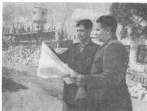
Строительство широкоэкранного кинотеатра на 500 мест в Городище. На переднем плане — прораб стройки П. Христин (слева) и заведующий районным отделом культуры Я. Летичевский
