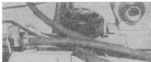
Рис. 1. Электроркланпан СКН-2 в сети подачи воды для охлаждения фильмового канала
